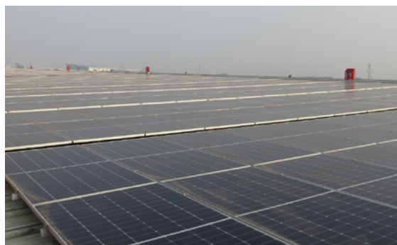
太陽光発電システム（ベトナム工場）
