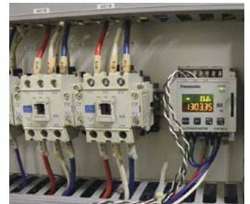
簡易電力センサー (浪岡工場の洗浄機の電力計測用)
