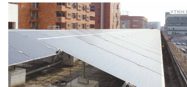
太陽光発電システム(中国・仏山工場)
